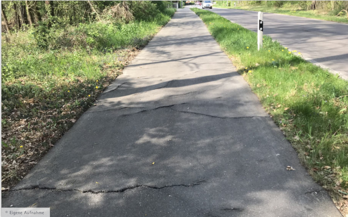
Abbildung 3-23 Beispielhafter Schaden eines Fahrbahnbelags an einem vorhandenen Radweg (T2)
