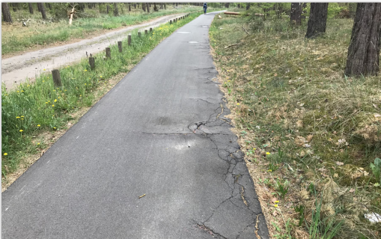
Abbildung 3-28 Beispielhafter Schaden eines Fahrbahnbelags an einem vorhandenen Radweg (T12)
